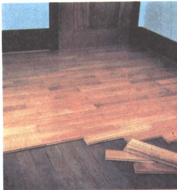
Fot. 1. Układanie parkietu z klepek o wymiarach 6x40 cm na starej, zniszczonej podłodze z desek. Poszczególne klepki łączone są z podłożem na gwoździe wbijane przez nasadę pióra
